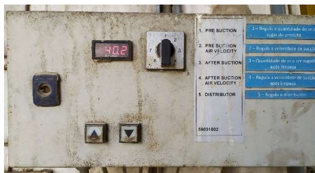
Figura 19 - Painel de controlo do peneiro Combi Cleaner .
